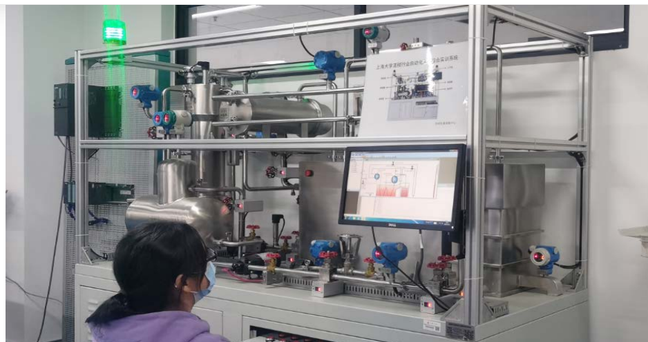
2、调试“过程控制综合实训系统”设备。
